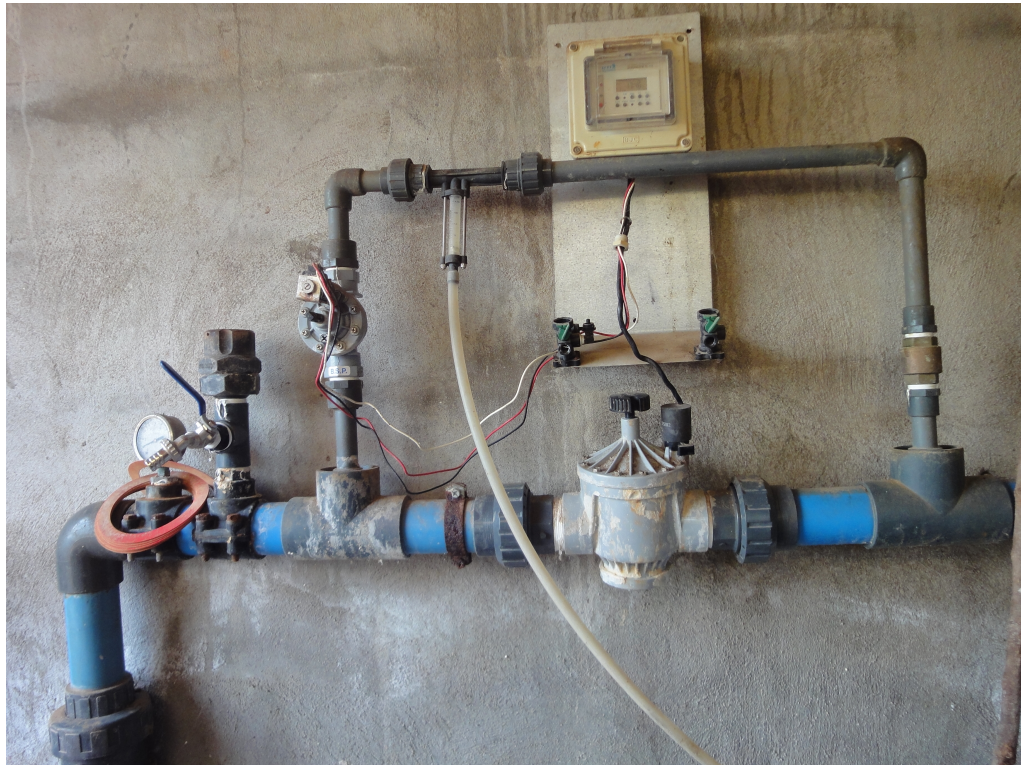
Figura 2.1: Instalación de riego actual.
