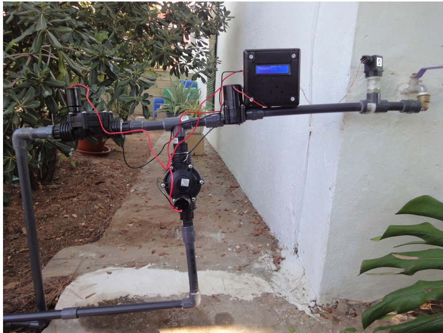
Figura 6.35: Instalación realizada para las pruebas de entorno real controlado
