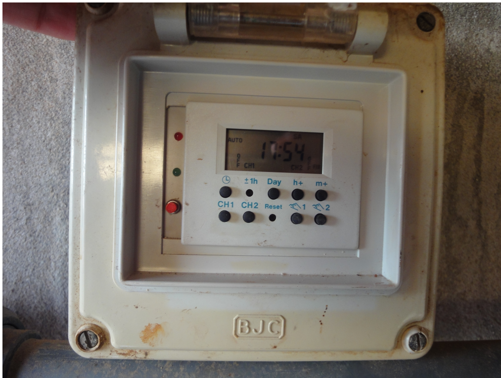
Figura 2.2: Programador actual: Irri 2 fabricado por Progres.
